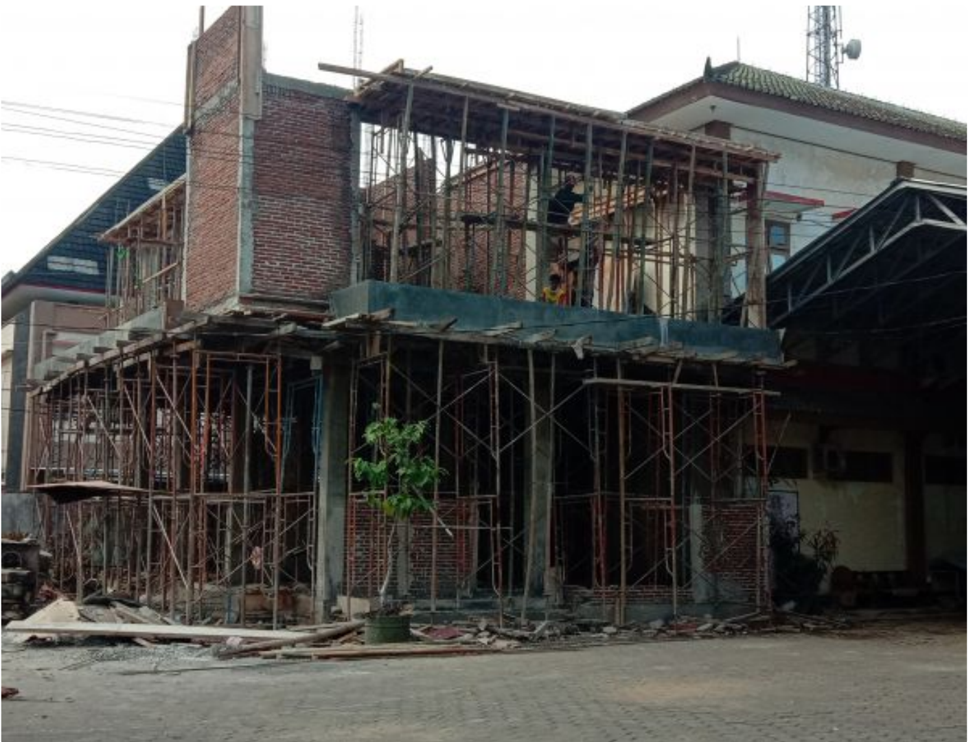
Gedung Bangunan Public Safety Center (PSC) 119 Yang sedang Dikerjakan di Dinas Kesehatan Kabupaten Purbalingga
